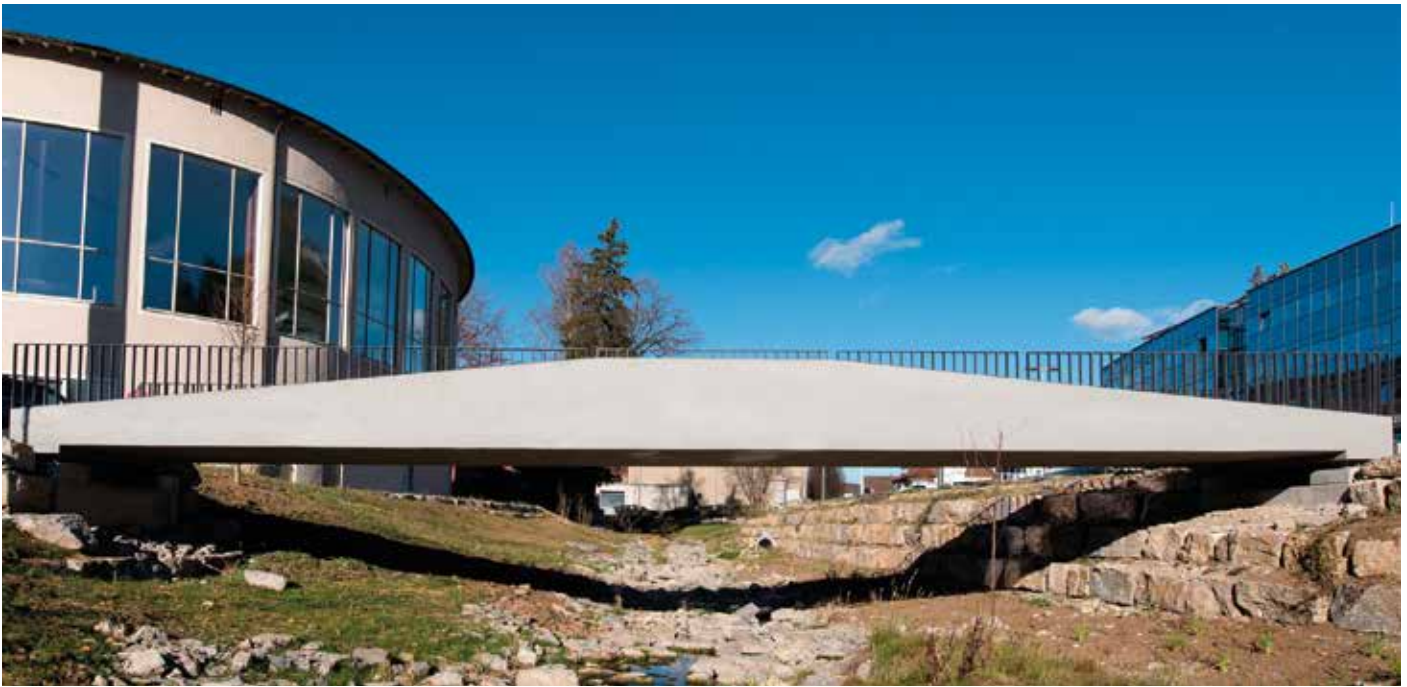
Ansicht der dünnen Seitenwände (70 mm) der ersten Carbonbetonbrücke, die vollständig auf Stahlbewehrung verzichtet
