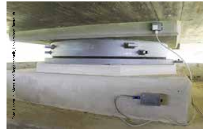
Sensoren zur Schwingungsmessung an einer Autobahnbrücke der A9 bei Trockau
