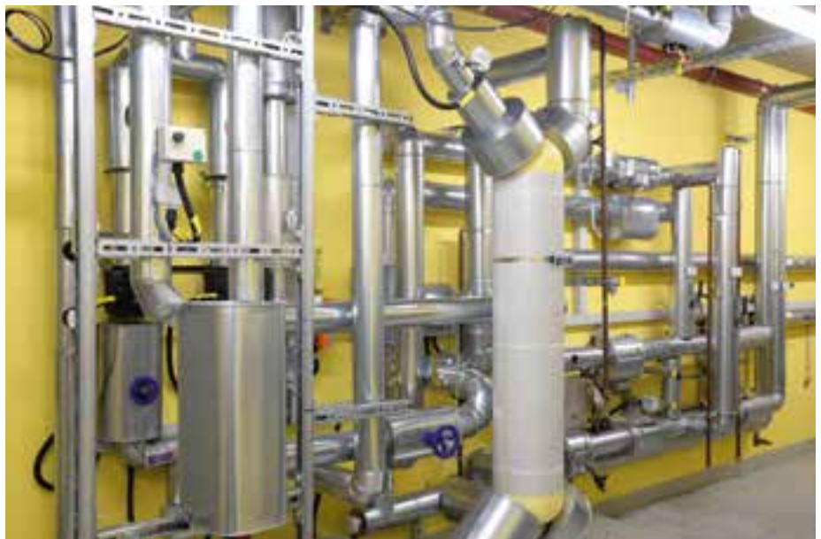
Hocheffiziente Trinkwassererwärmung in einer Wohnanlage der GEWOFAG in München-Riem
