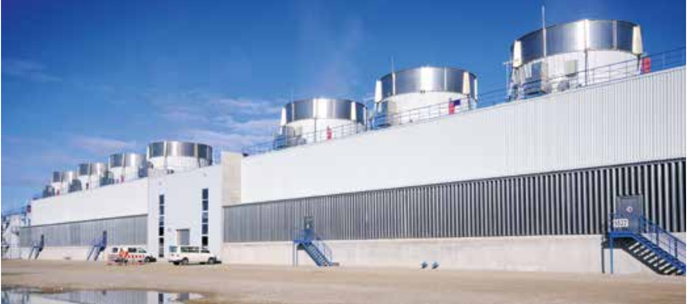
Bis zu 14.000 Kubikmeter Wasser können pro Stunde in den acht Kühltürmen im Norden des Werks umgewälzt werden. Die Temperatur im Kühlkreislauf kann damit um bis zu 10 Kelvin abgesenkt werden
