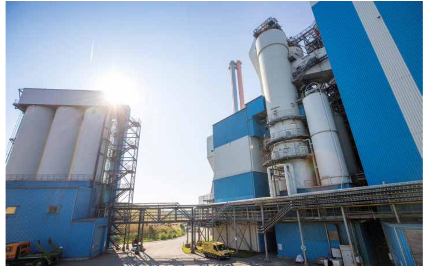
Blick auf die bestehende RGR 4 im Anschluss an das auf der rechten Seite noch erkennbare Kesselhaus. In Bildmitte finden sich die Kalksilos, die Reaktoren sowie der Gewebefilter (mit Saugzug im Untergeschoss), die neu errichtet werden
