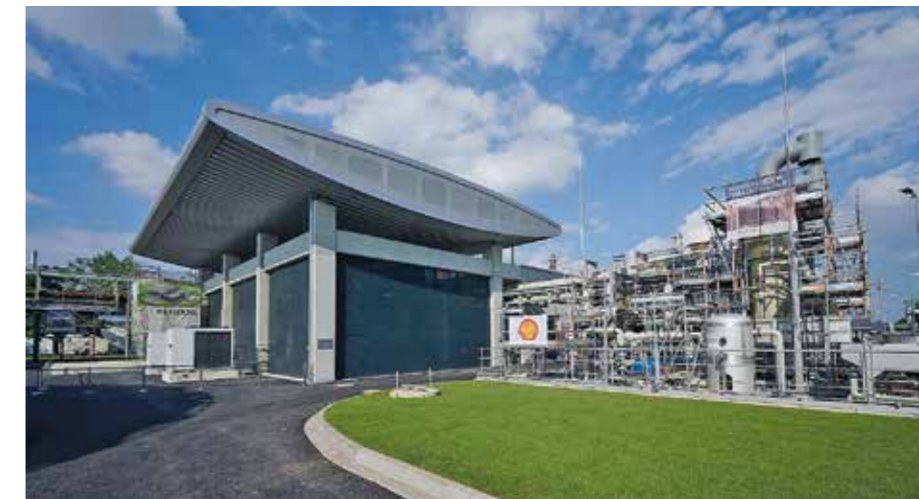
Die REFHYNE-Anlage zur Herstellung von grünem Wasserstoff
