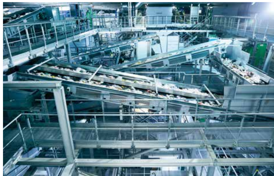
Die LVP-Sortieranlage in Eitting ist die derzeit modernste in Europa und übertrifft alle vom Gesetzgeber vorgeschriebenen Sortierquoten
