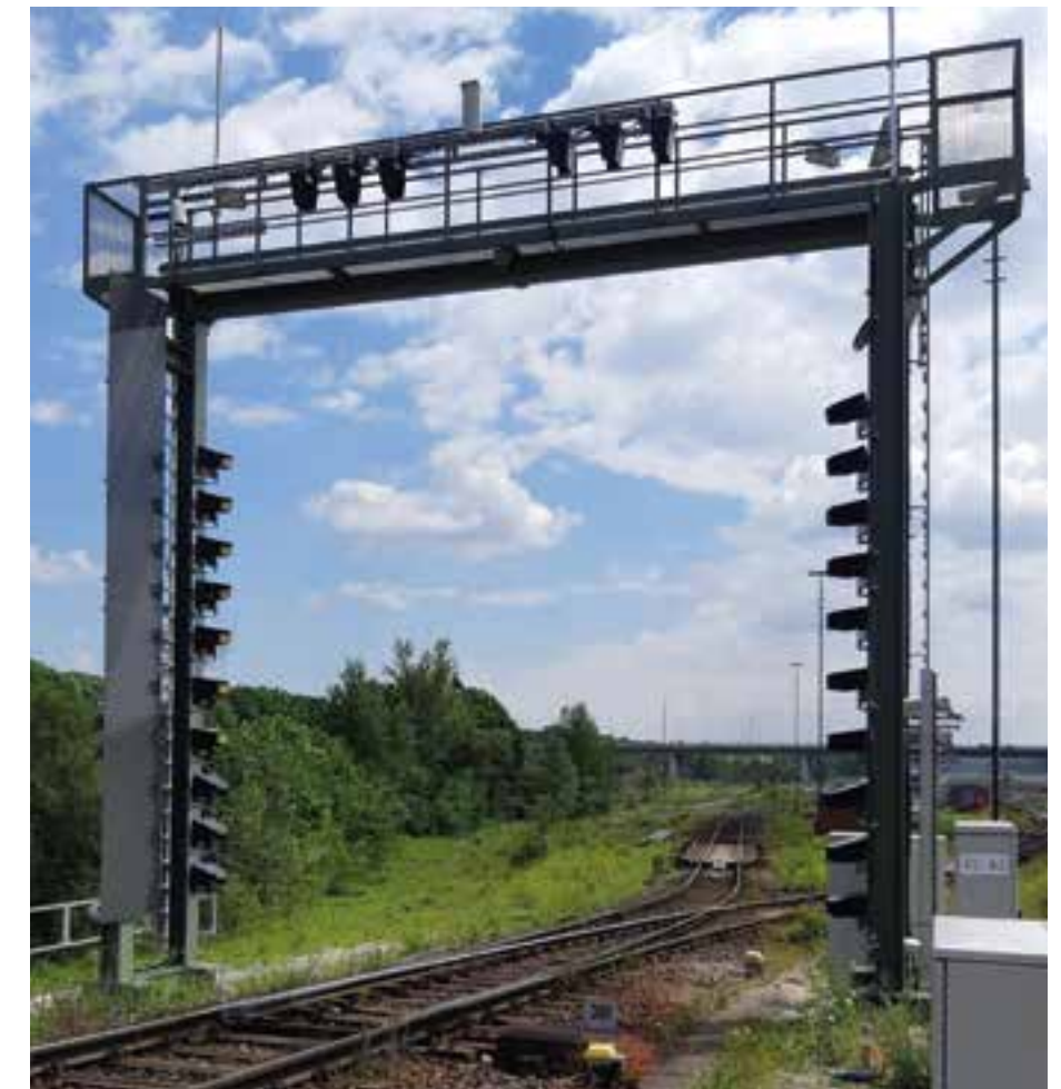
Kamerabrücke zum Testen der digitalen Zuginspektion in München-Nord
