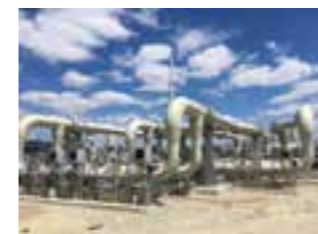
Titelbild: Gasleitungen bei der Verdichterstation Haiming Foto: bayernets
